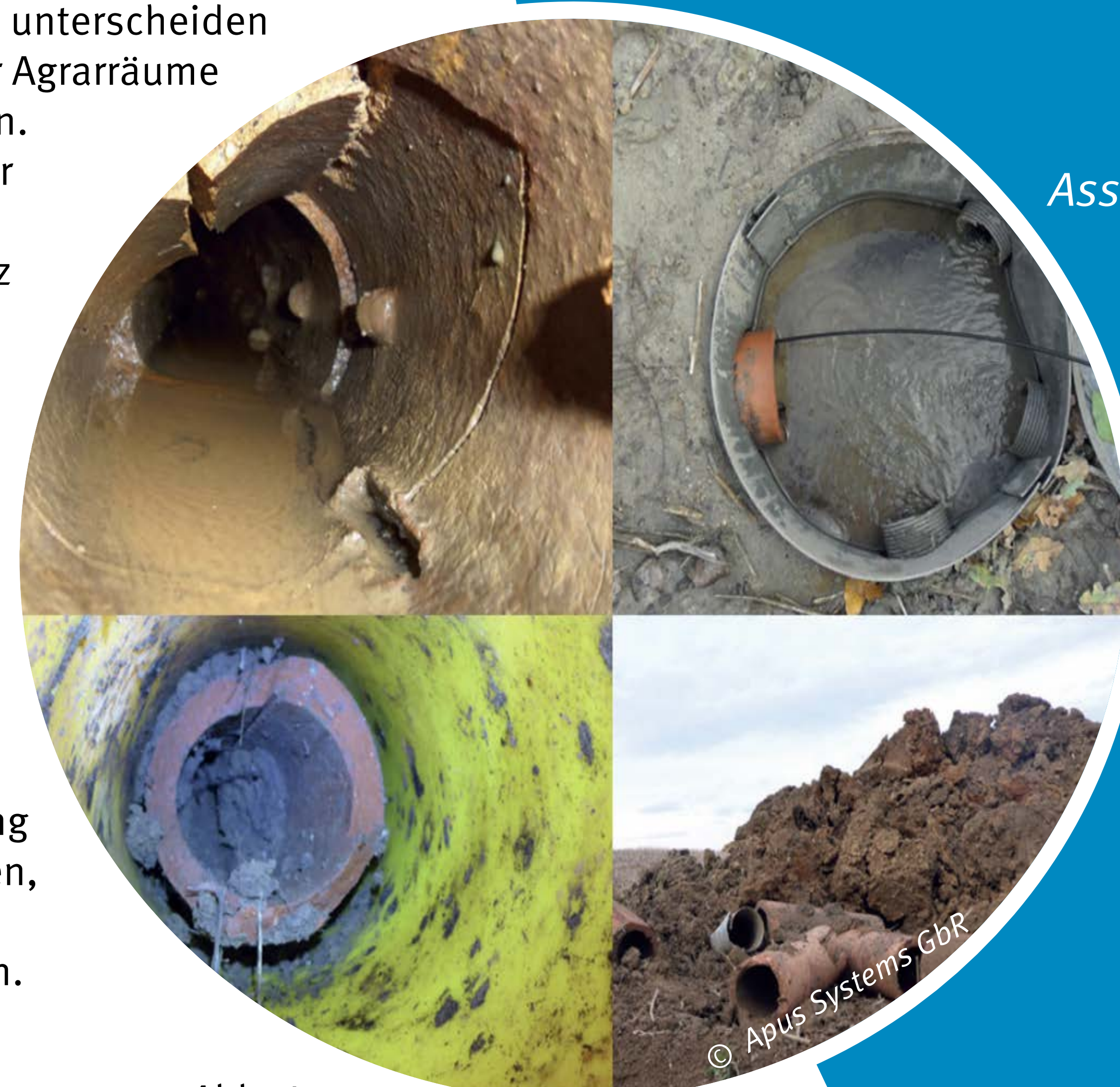
Abb. 4: Defekte und verstopfte Dränagen
