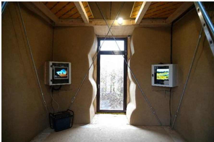
Abbildung 61 Messwerterfassung im Forschungsdemonstrator: Windmonitoring und Dehnungen an den Gewindestäben des Aussteifungssystems (linker Monitor); Temperatur- und Feuchtemonitoring (rechter Monitor)
