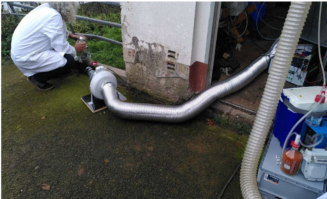
Abbildung 5.1.3: Lüfter mit Abluftschlauch (links) und Rohabluft(Zuluft)schlauch (rechts) inkl. mikrobiologischer Probenahmetechnik (rechts)
