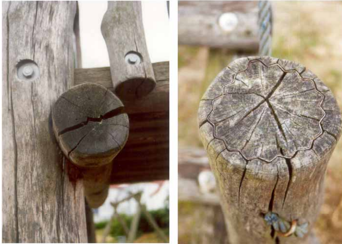
Pfosten und Holzkonstruktion stark gerissen
