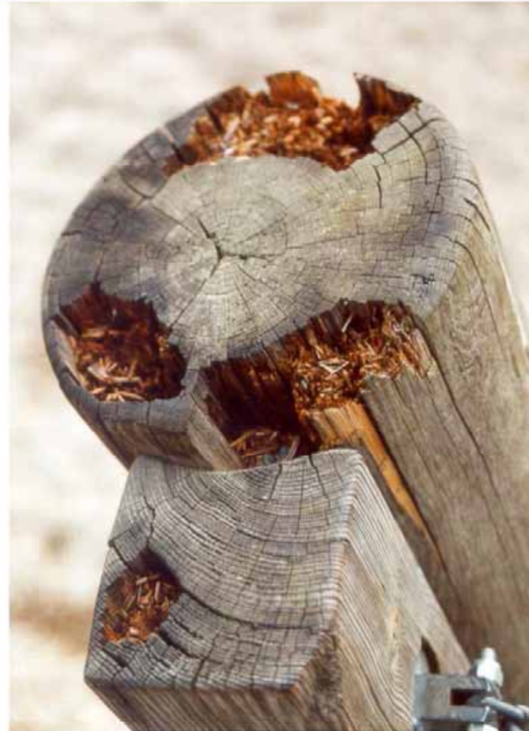
obere Bauteilenden; intensive Auffeuchtung über Holzquerschnitte; GK 3.2
