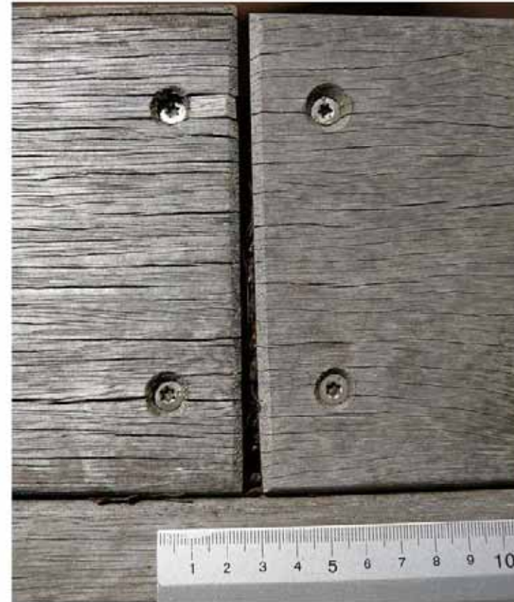
Rissbildung am Bauteilende; Schraubenabstand zum Bauteilende zu gering
